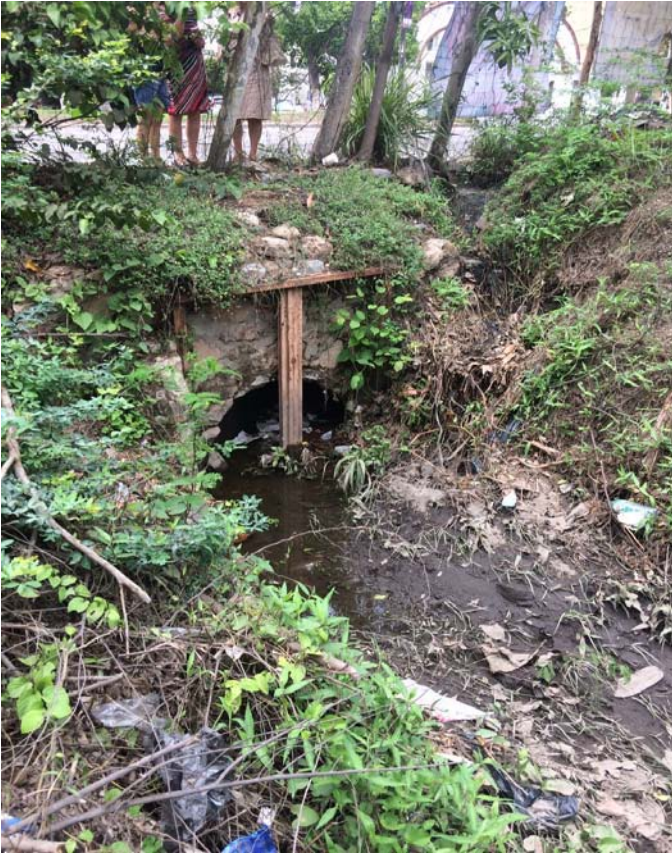
Boca de tormenta destapada para que no se inunde el fraccionamiento Vallarta 500.
